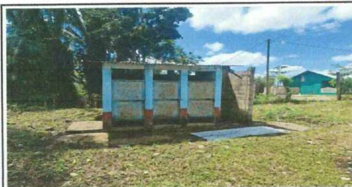
Foto 3: MEJORAMIENTO DE SANITARIOS, EN MAL ESTADO Y EN USO
